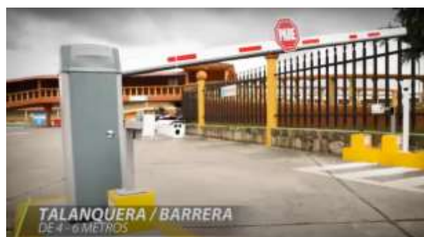
Figura 107. Sistema de control de acceso vehicular.
