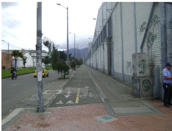
CICLO RUTA – CARRERA 39 CON AVENIDA CALLE 13 AL NORTE. ESTADO ACEPTABLE
