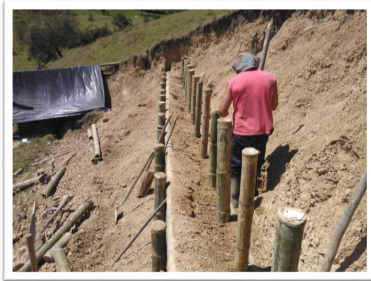
Foto 14. Construcción del segundo nivel o balcón de la terraza, distancia 0.70 m distancia que depende de la pendiente del terreno, se construye de la misma forma que el primer nivel y se continúa hasta llegar a la corona del deslizamiento.
