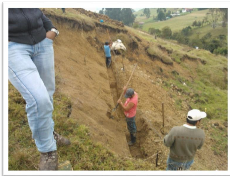
Foto 11. Zanja perpendicular a la pendiente del terreno con profundidad 0.70 m o hasta encontrar suelo firme, y ancho de 0.50 m que servirá como base de la terraza. Esta zanja debe estar empotrada a los costados del cuerpo del deslizamiento aproximadamente 0.80 m, esto con el fin de anclar la estructura.
