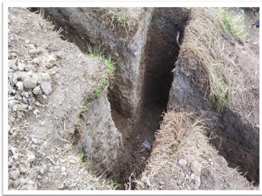
Foto 3. Construcción de canal perpendicular al filtro con una profundidad de 0.20 m por debajo del nivel del filtro, y una longitud de 2.50 m y un ancho de 0.50 m.
